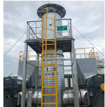
焊接烟尘活性炭+排气筒2#
