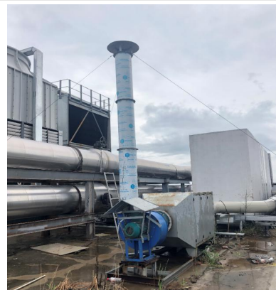
清洗废气活性炭+排气筒3#
