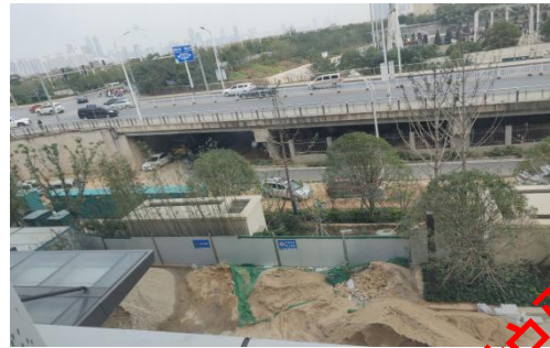
柴油发电机废气排放口
