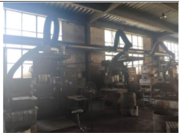
排气筒P2集气管道
