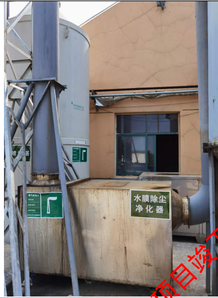
水膜脱硫除尘设备标识
