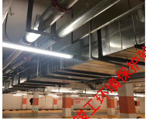
地下车库排烟管道
