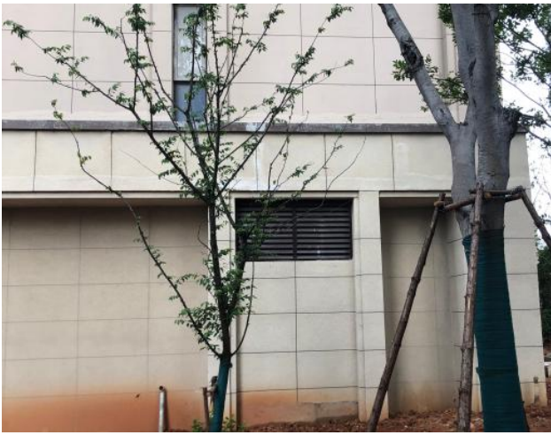
地下车库排烟口
