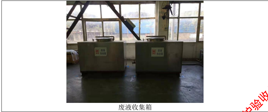
图4.1-2 项目废水治理设施设置情况照片
