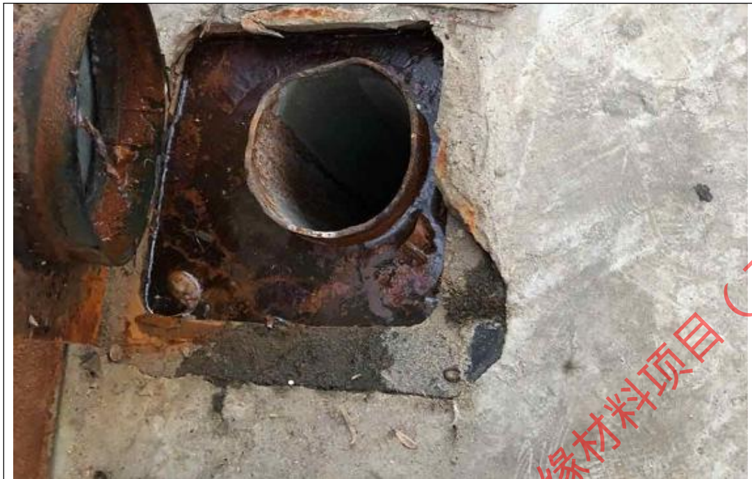
地下水监测井
