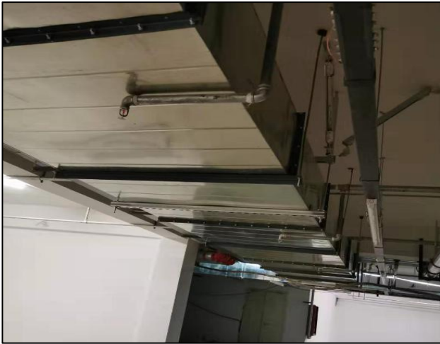
地下车库排烟口
