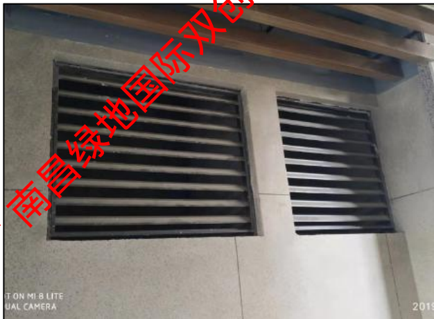
地下车库排烟口
