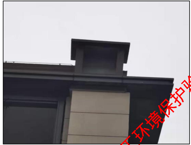
居民油烟排放口
