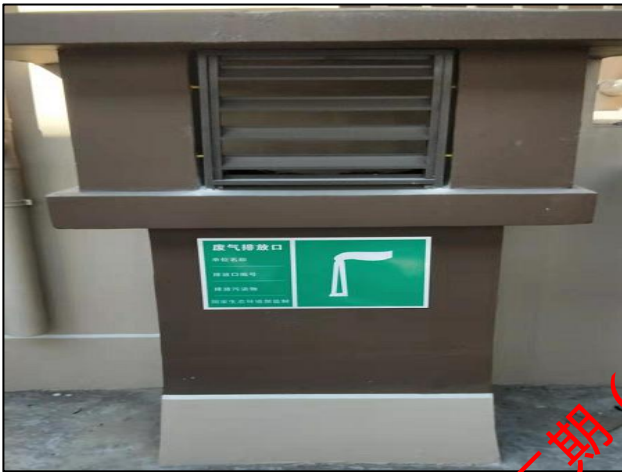
柴油发电机废气排放口
